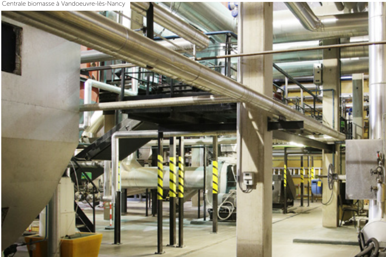
Centrale biomasse à Vandoeuvre-lès-Nancy
